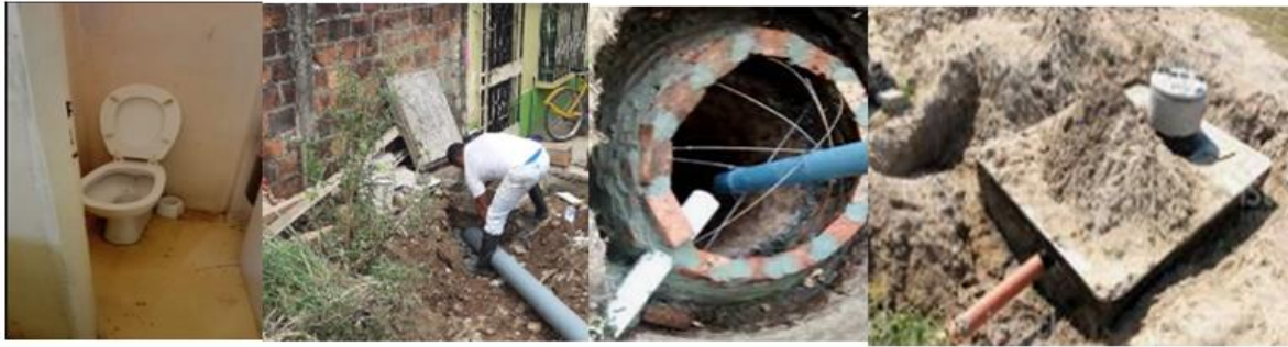
Excusado conectado a pozo ciego
